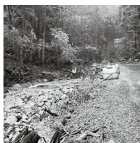
胡桃田沢で被災した取水施設と応急設置の水道タンク
