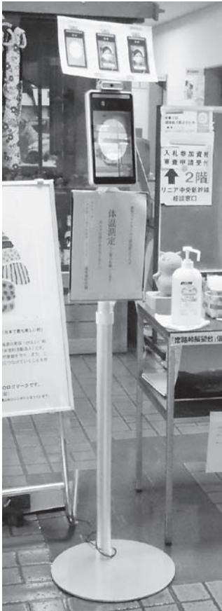
役場1階ロビーに設置された非接触式検温器
