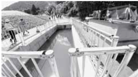
盛土最下部に設けられた排水処理施設
