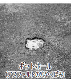
ポットホール (アスファルトの穴やくぼみ)
